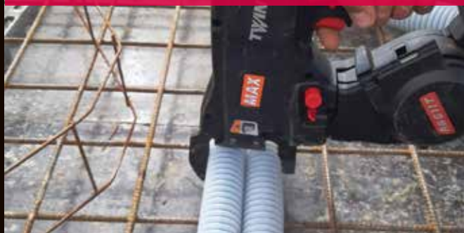
Przewody elektryczne i hydrauliczne
